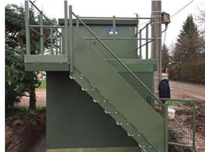
Figure 32 : Exemple de poste de transformation et de livraison HTA/BT réhaussé (rehausse pssa)
